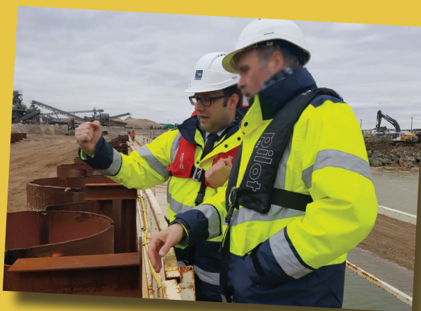
Loïg Chesnais-Girard en visite sur le chantier du polder de Brest le 22 mars 2018 © Région Bretagne
